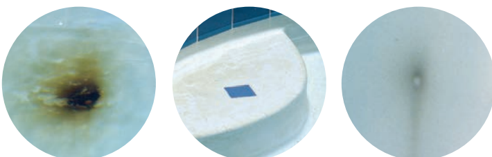
Mancha de óxido
