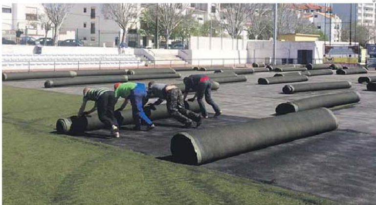
Equipa de operários e engenheiros ucranianos, além de maquinaria, começou as obras de substituição dos dois sintéticos da formação
